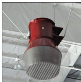
Generadores de Alta Expansión
