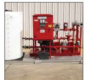
Sistemas de Proporcionamiento con bombas diesel
