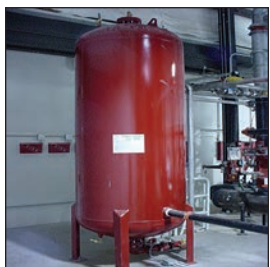
Tanques de Vejiga
